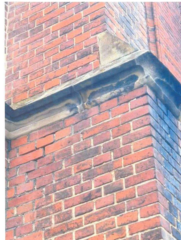
14. Zły stan techniczny skarp kamiennych i elementów kamiennych oraz elewacji ceglanej kościoła.
