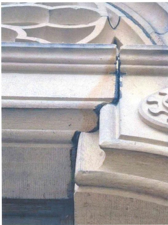
5. Przesunięcia kamiennych elementów nadproża.
