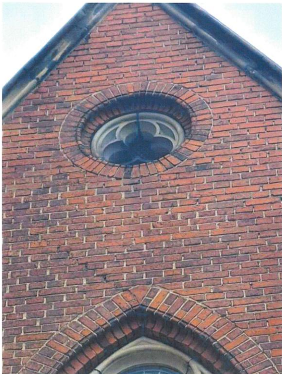
18. Pęknięcie ściany nośnej nawy bocznej . Zły stan techniczny skarp i elementów kamiennych oraz elewacji ceglanej kościoła.
