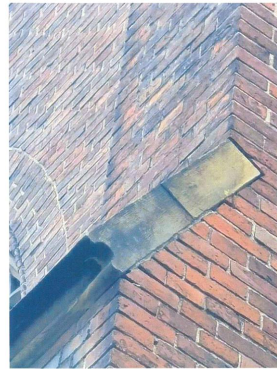
9. Zły stan techniczny skarp kamiennych na przyporach ceglanych.
